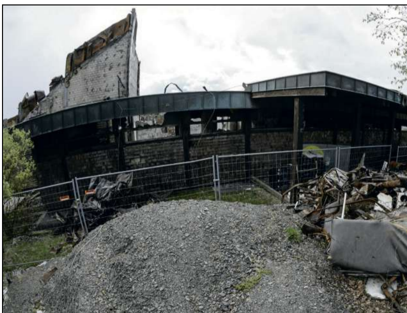
Inzwischen ist der Schutt weg, aber an der Brandruine in Fichtelberg hat sich noch nichts getan. Foto: Wittek
